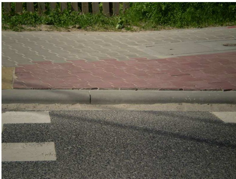
Fot. 4. Wysoki krawężnik na przejeździe przez ul. Krakowską
